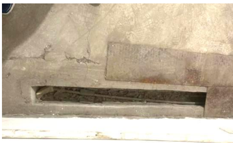
图10.3-6 机房“U”型地沟
